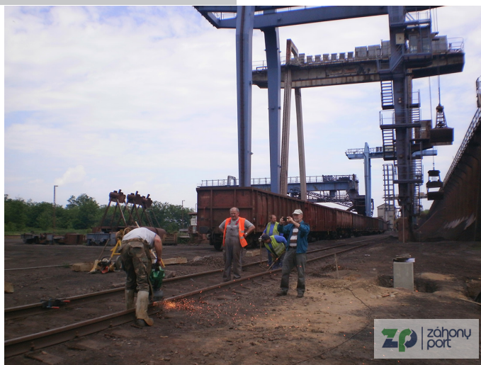
Az első munkafolyamatok a mérőberendezés telepítésekor
